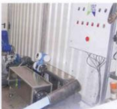
Die Ultraschalleinheit Biopush von Weber, hier auf einer Anlage in Jena.
