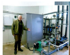
Heinrich Siemering zeigt die Klimaanlage für seinen Putenstall. Betrieben wird sie mit der Wärme aus dem Biogas-BHKW.
