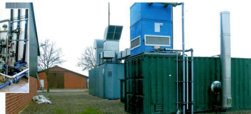
Die Wärme des Satelliten-BHKW (Bildmitte) liefert die Energie für die Stallklimatisierung. Der blaue Aufbau ist der Rückkühler. Fotos: Siemering
